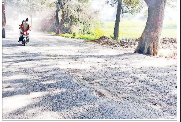
कनीना। उन्हाणी के समीप से गुजर रही रामपुरी डिस्ट्रीब्यूटरी के लीकेज साइफन से टूटी सड़क। फोटो: हरिभूमि
